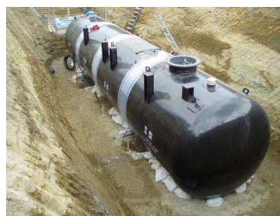
非常用飲料水貯水槽
