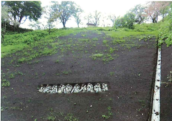
図 13 楯山公園北側斜面の地下水排出のための 排水パイプ
